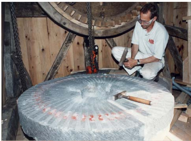
Bilning af løbereen – en rihnsksten – i Egeby mølle, af tømrer Bo Johansen. 1998.
